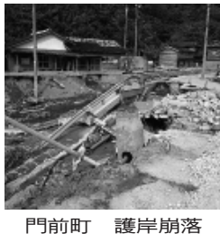
門前町 護岸崩落
